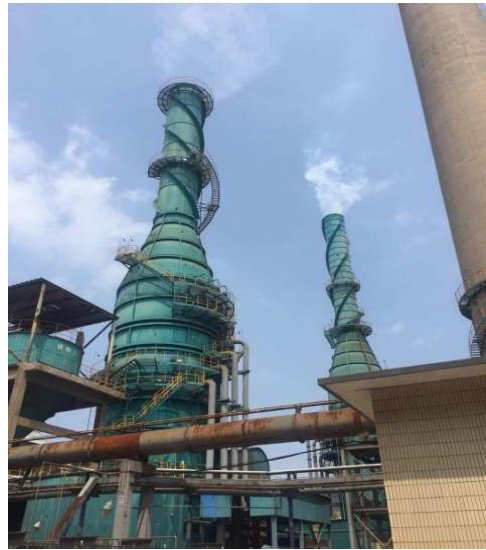
自备电厂脱硫系统
