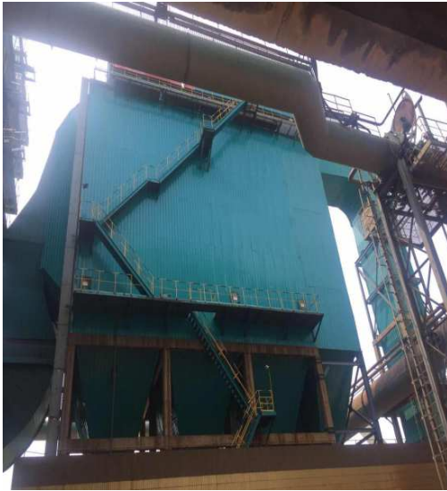
自备电厂脱硝系统
